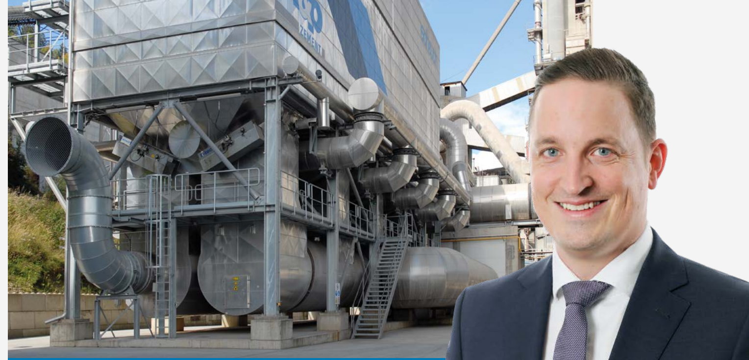
Schadstoffe kommen hier nicht durch: Seit 2017 ist die RTO-Anlage am Standort Wietersdorf in Betrieb.
